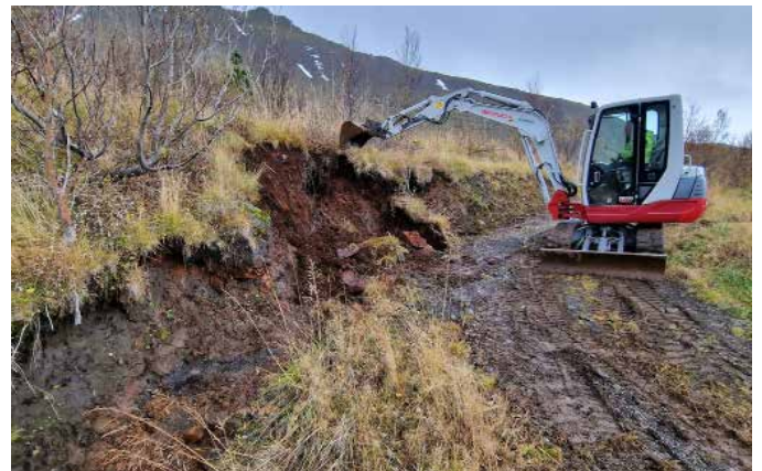
Beygjan á þessum stíg er of kröpp og moldarbarðið of bratt. Úr því hefur hrunið, vatnsrás undir stíflast og vatn flætt niður eftir stígnum og skemmt hann (Mynd: JBB).
